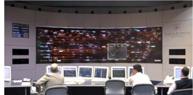
Electrical Control Center of Red Eléctrica (CECOEL)
